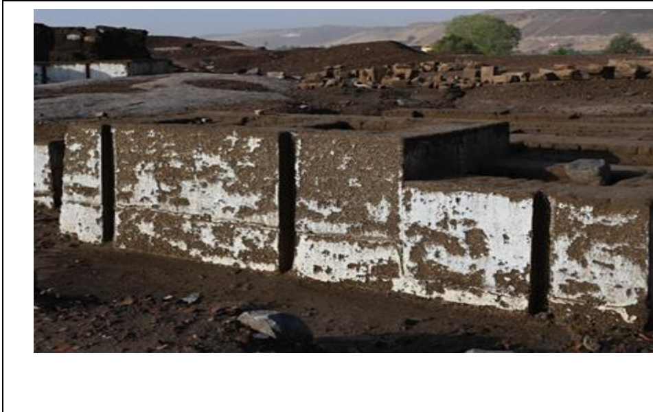
الشكل (5) يوضح تآكل الأسطح المغطاة بالطين والمعرضة لهطول الأمطار على مصاطب الدولة القديمة التي أعيد بناؤها، باتجاه الجنوب مصطبة 5
